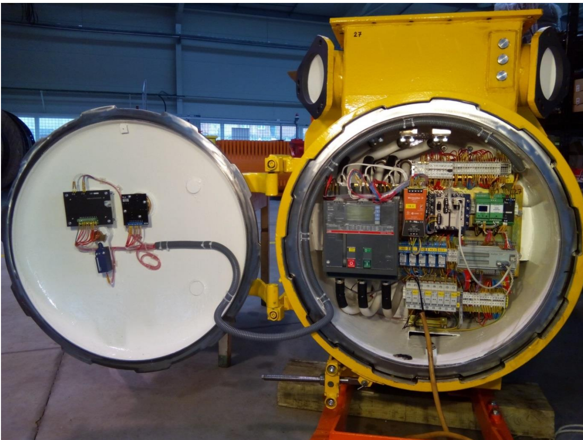
Obrázek 1 - kompletně vybavená nízkonapěťová strana transformátorové stanice IT35b-Q4 o výkonu 400 kVA
